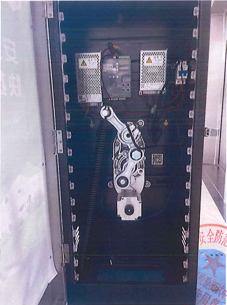
图四、D203-207-209 型广告道闸机箱内部布局
